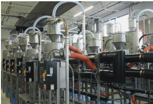
El aire seco circula en cada tolva a través de un colector de circuito cerrado (manifold).
